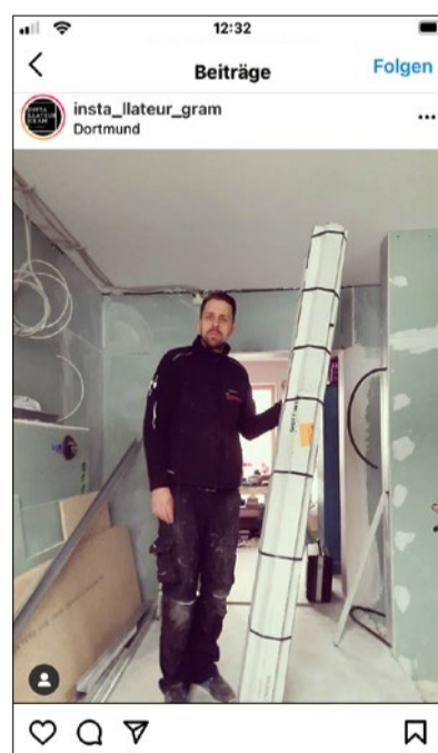
insta_llateur_gram Die Frage die ich euch stelle, was verbirgt sich da im Karton was ich gleich einbaue ...?
